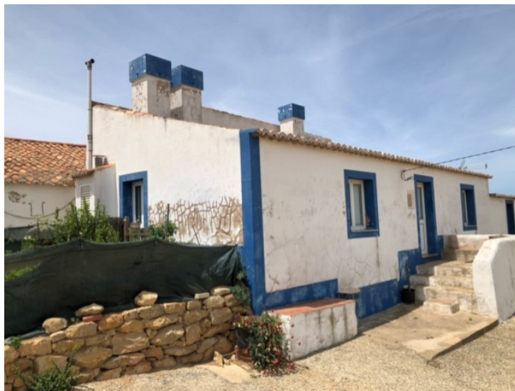
Figura 1.12: Habitação de planta rectangular em taipa, rebocado a cal e orientada a nascente, localizada em Montinhos do Burgau, Lagos.
